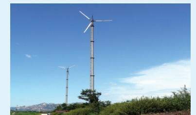
< 소형풍력 설치 예 >
